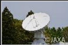
衛星通信アンテナ
